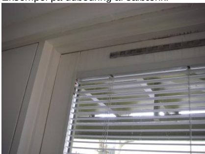
Utæthed forårsaget af utæt vinduesparti på ovenlæggende etage.
