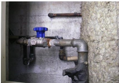
Eksempel på grubetæring af stålør
