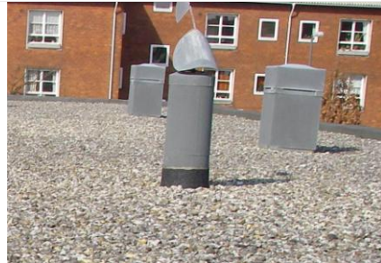
Skorsten samt 2 tagventilatorer
