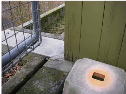
En dårlig udførelse af afskærmning mod nabo
