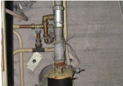
Eksempel på grubetæring af stålør
