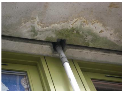
Afløb fra altankasse er utæt
