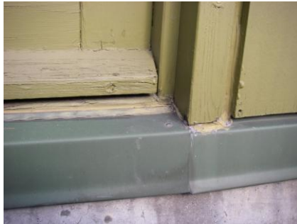
Dårlig udført inddækning
